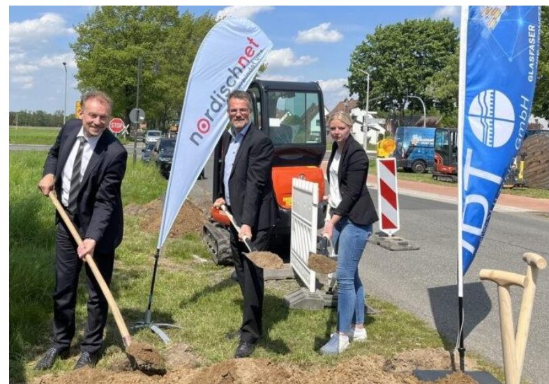
Symbolischer Spatenstich (v.l.n.r.): Andreas Niehaus (GVG-Gebietsleiter), Bernd Bormann (Bürgermeister Bruchhausen-Vilsens) und Marina Lange, (technische Leiterin GVG Glasfaser)
